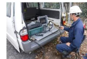
3.清掃ロボット 操作状況
